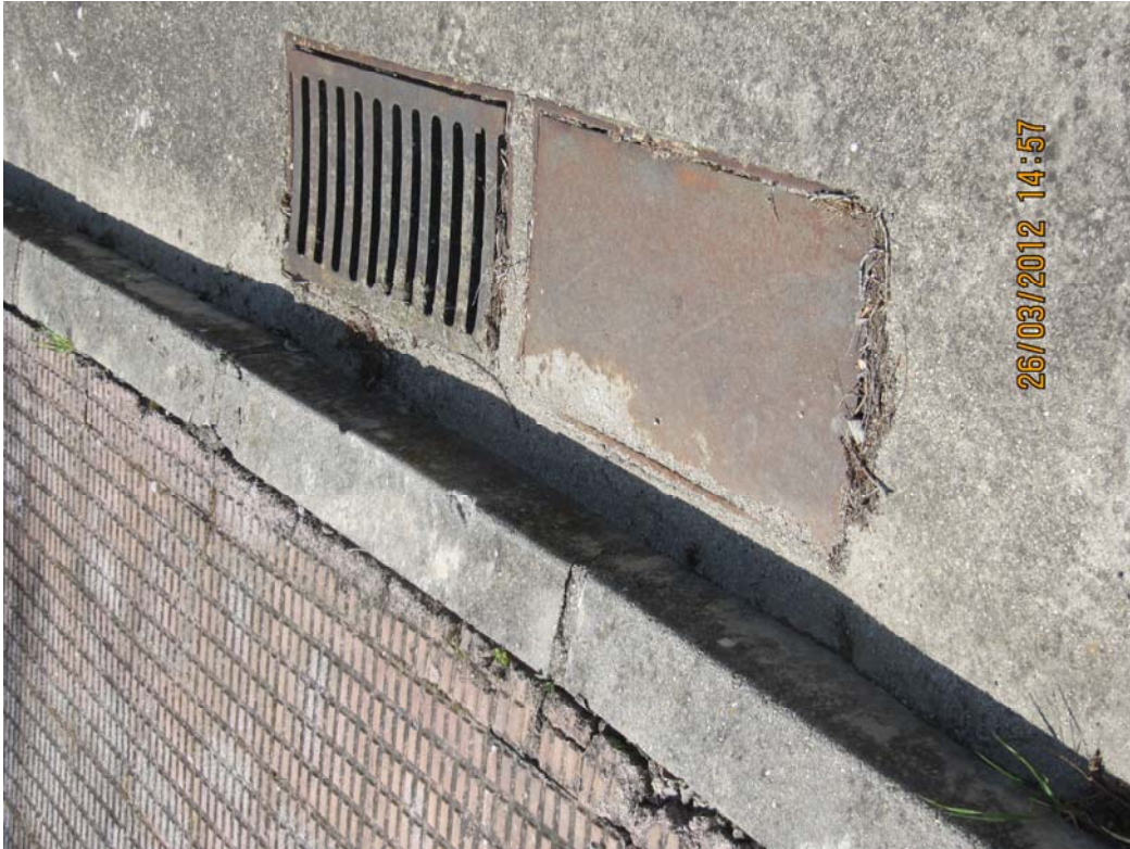
32- Red de recogida de aguas pluviales
