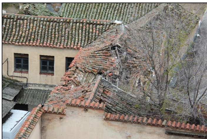
Estado de la cubierta de la nave norte.
